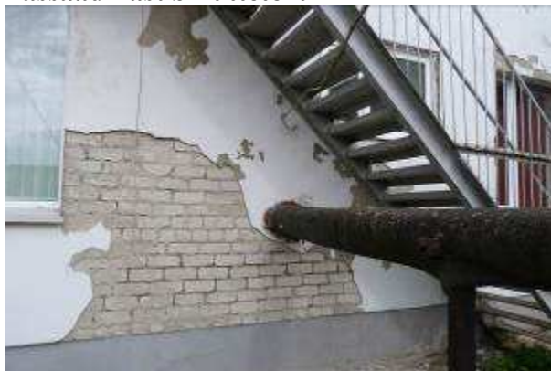
Fassaadil asub küttetoru
